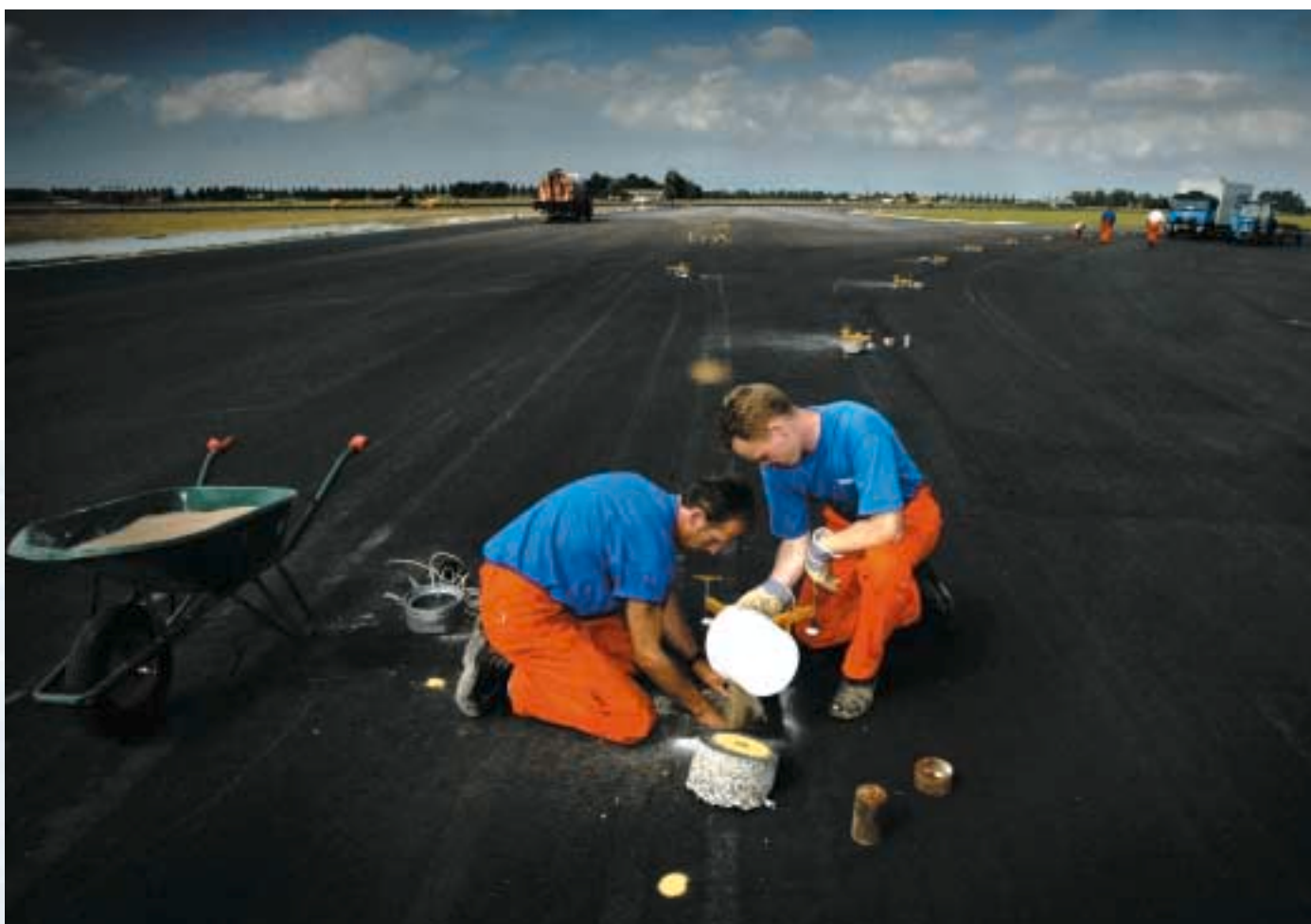
Er wordt hard gewerkt aan de vijfde baan zodat deze op 1 januari 2003 gereed is voor gebruik.
